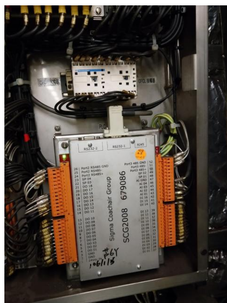
捷運車廂 381 空調系統-整改前
